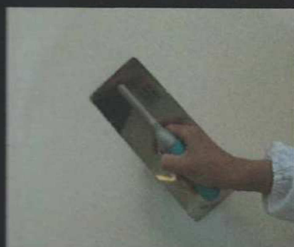
Rasatura con Plastuc Tipo A (Opzionale) Levelling with Plastuc Tipo A (Optional)
